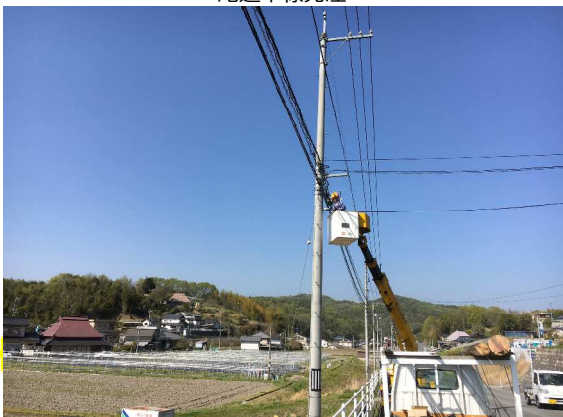
尾道市内防犯灯取替
